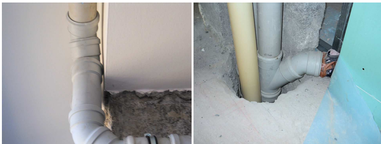
Figura 7-5: Rumore generato dai contatti rigidi tra tubazioni e muratura - DA EVITARE
